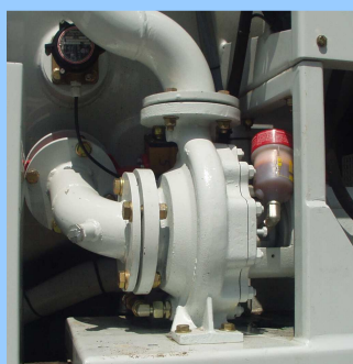
Pompe de transfert
